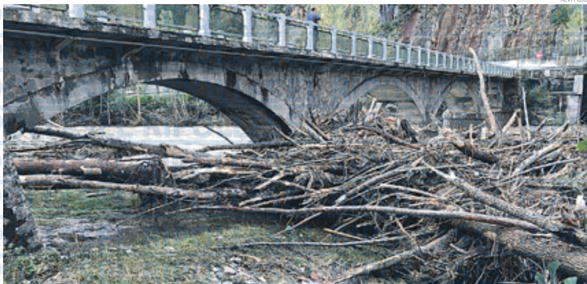
Troncs acumulats en un dels pilars del pont de la Colònia Santa Maria, a Ripoll
