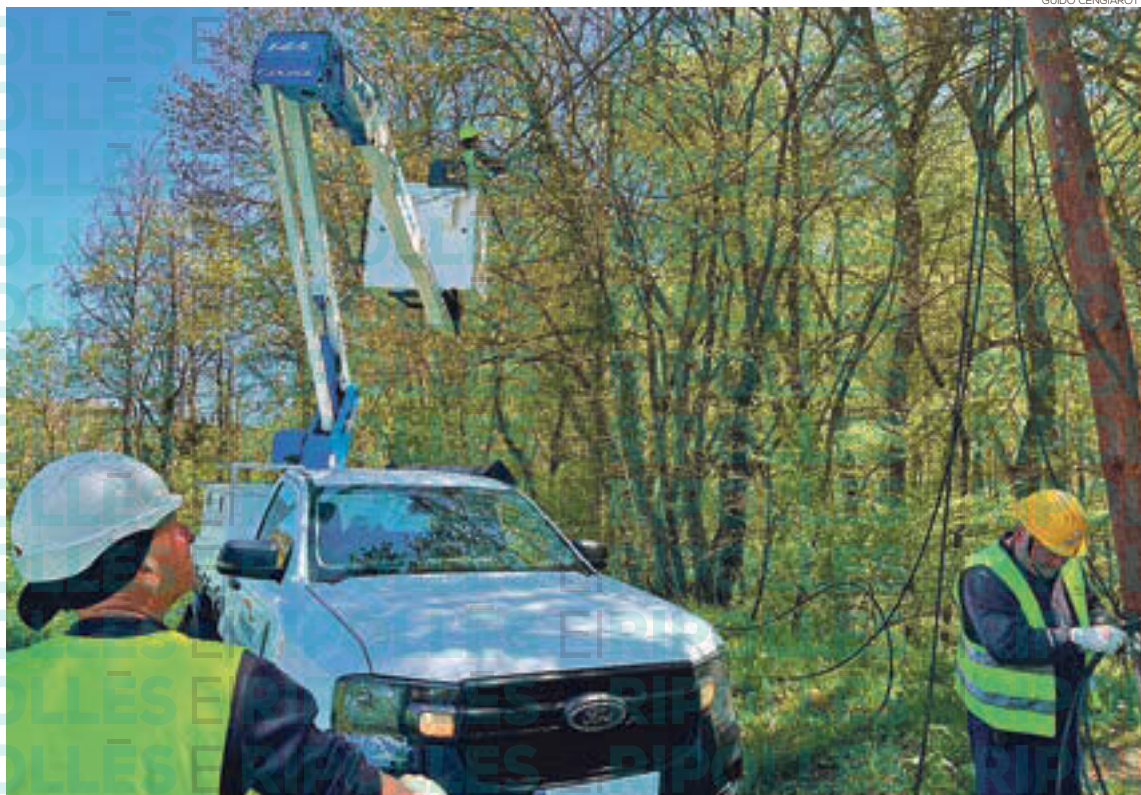
Així va quedar el cable que van tallar els lladres, pensant-se que era de coure
