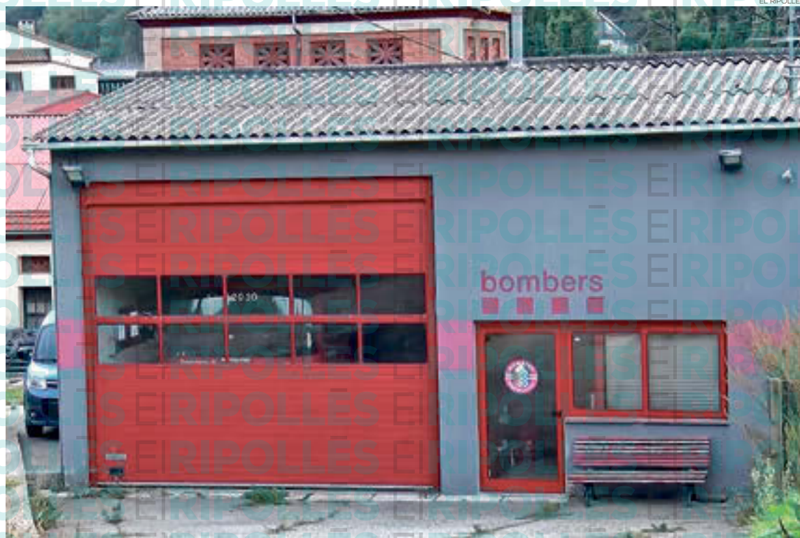
La coberta del parc de Bombers de Ribes és de fibrociment i la Generalitat obliga a retirar-la
