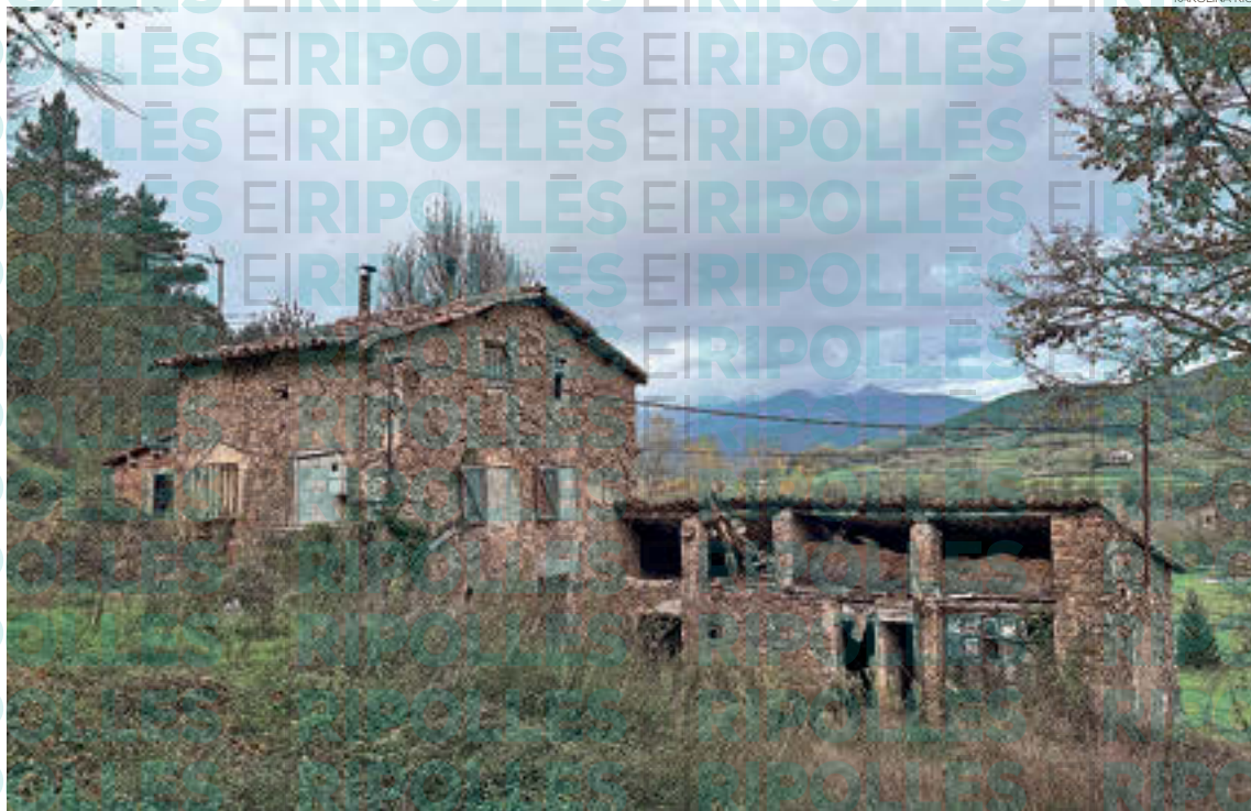
L'estat de la Caseta d'en Jordana
