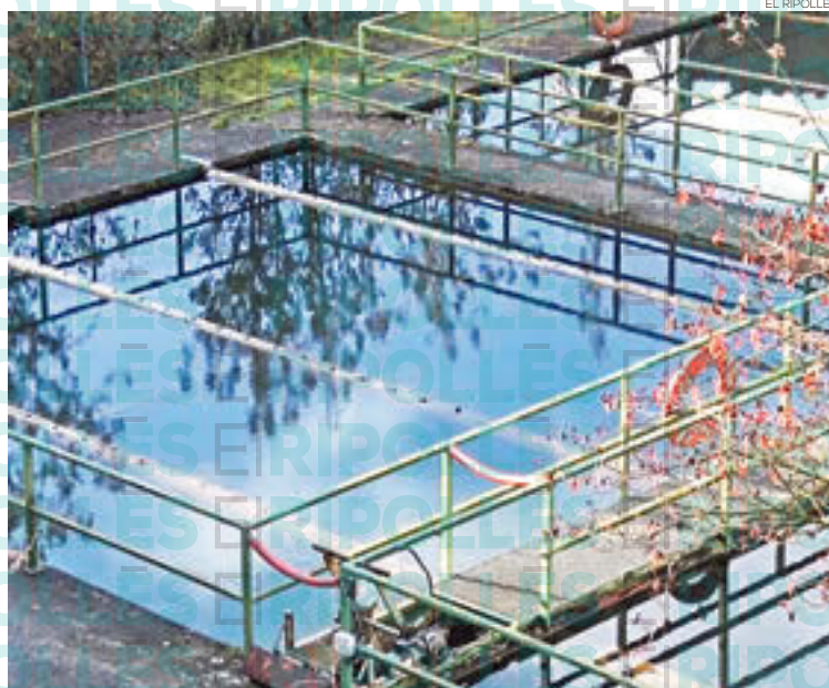
L'Estació de Tractament d'Aigua Potable de Ripoll i Campdevàrol
