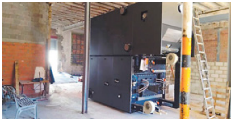
Les calderes ja estan instal·lades a l'espai
