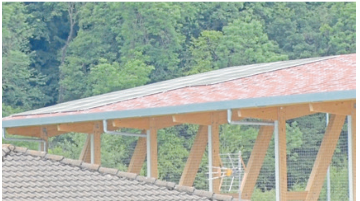
Les plaques a la pista poliesportiva de Vilallonga de Ter
