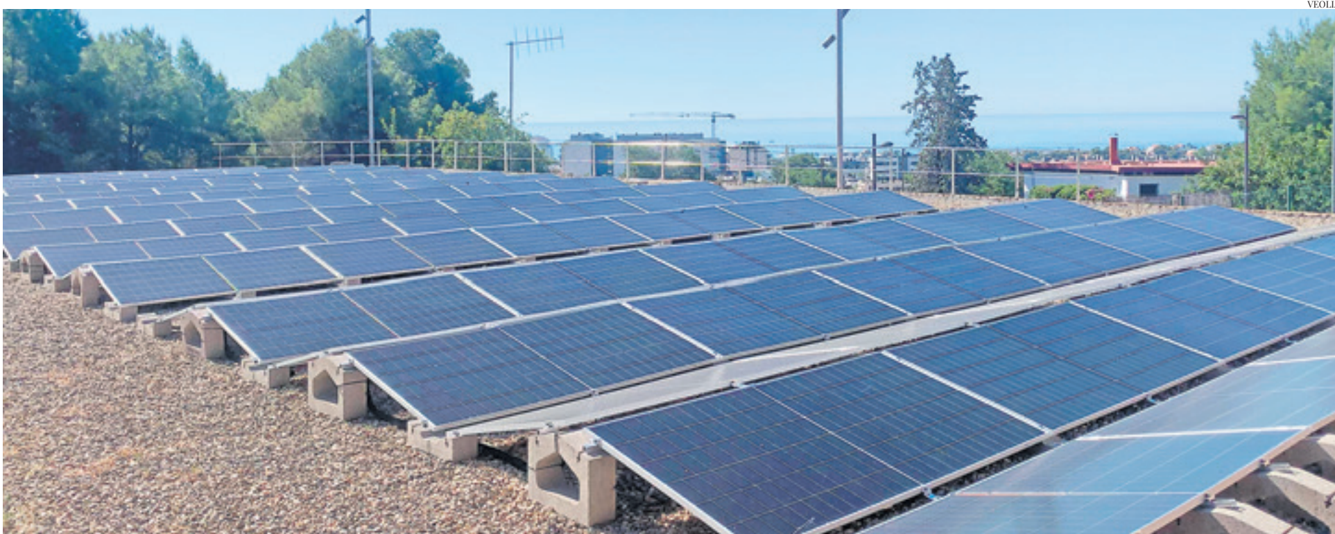
Instal·lació fotovoltaica al dipòsit Adela de Sitges
