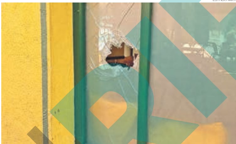
Vidre trencat d'un restaurant a Ripoll
