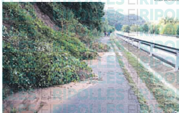
Una esllavissada que afectava la Ruta del Ferro, el passat cap de setmana
