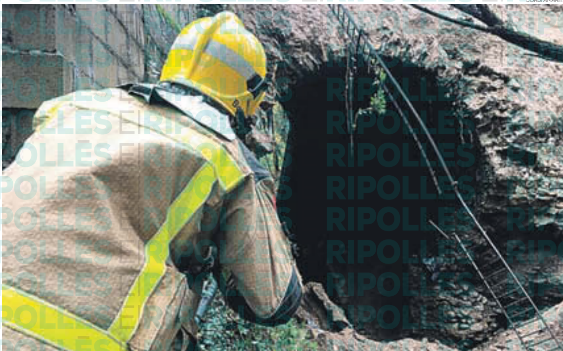
L'esvoranc va afectar el Torrent d'Oganes, que passa per sota de la N-260
