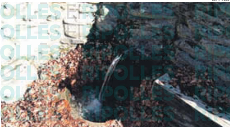
Actualment la instal·lació pateix una reducció de la quantitat d'aigua
