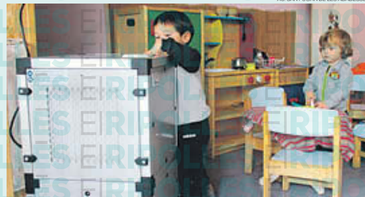
El sistema ja està instal·lat i en funcionament
