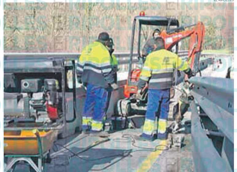
El passat any 2018 s'hi va dur a terme una intervenció d'urgència
