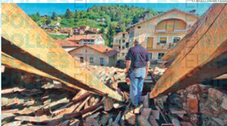
Els desperfectes de l'estructura requereixen actuacions urgents
