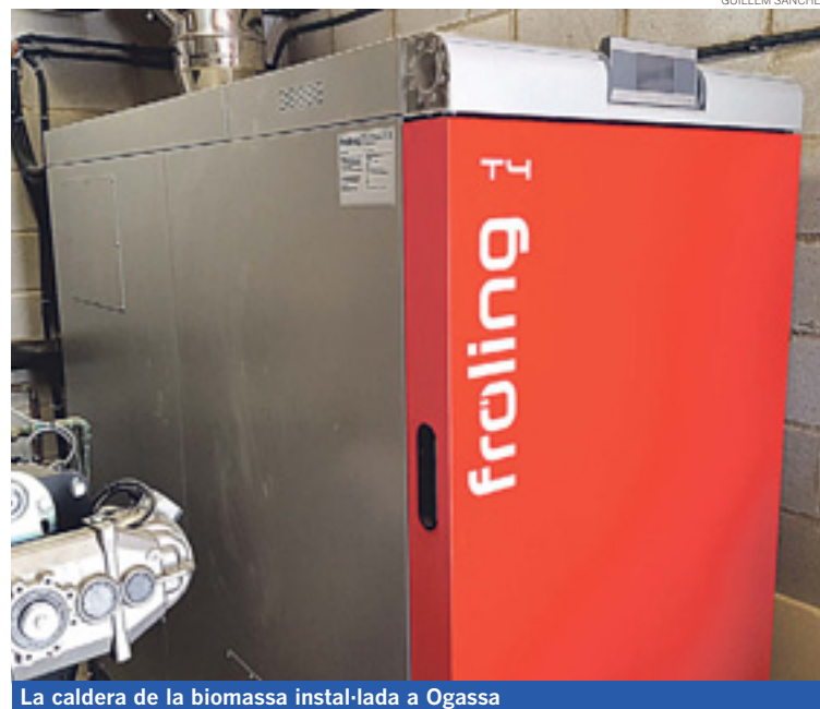
La caldera de la biomassa instal·lada a Ogassa
