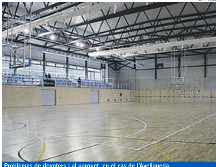
Problemes de degoters i al parquet, en el cas de l'Avellaneda
