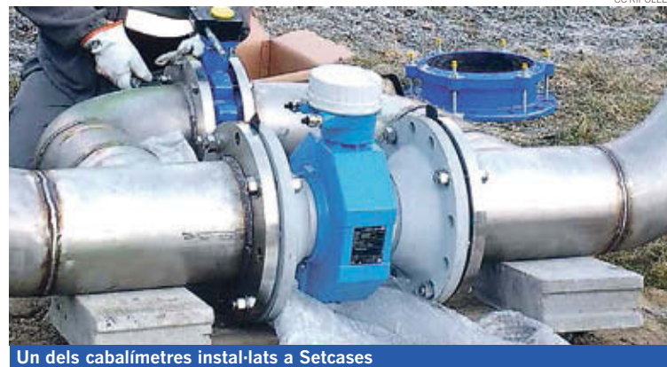
Un dels cabalímetres instal·lats a Setcases
