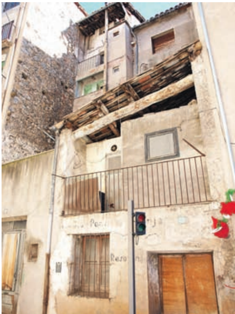
Decadència d'un edifici del casc antic de Ripoll
