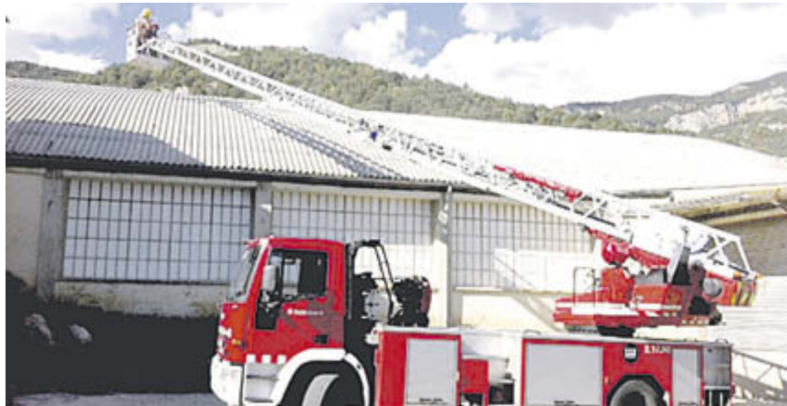
El sostre de la fàbrica va ser la part més afectada per l'incendi
