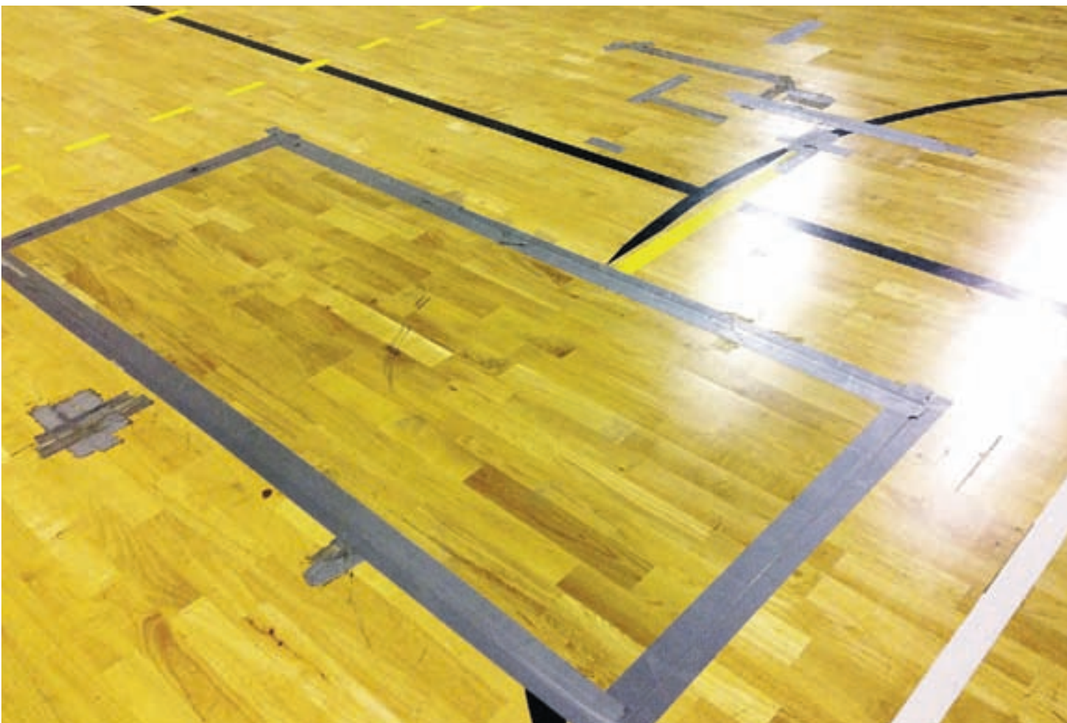
Aquest és l'estat lamentable que presenta el terra del pavelló de l'Avellaneda que ara s'haurà de canviar de nou només tres anys després de la seva inauguració C. GRANÉ
