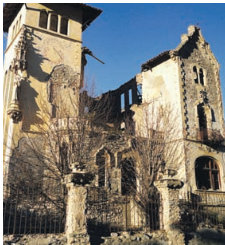
L'estat actual de l'edifici, ruïnós
