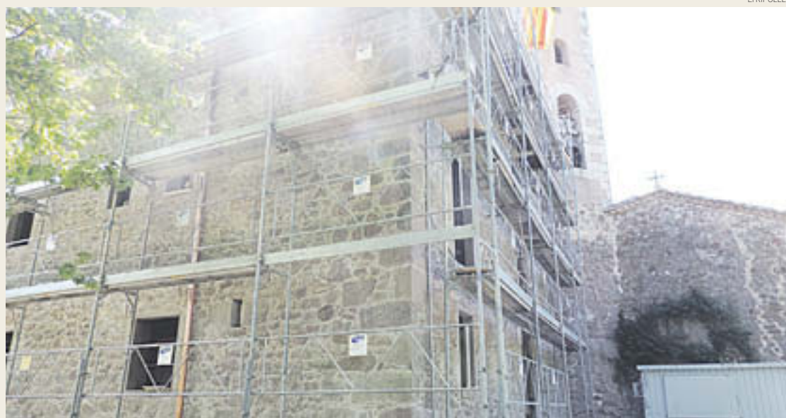
Estat de les obres que s'estan fent en aquests dies a l'entorn de la masia, al costat de l'ermita
